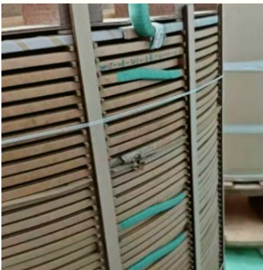
图4 C 相高压线圈轻微烧蚀
